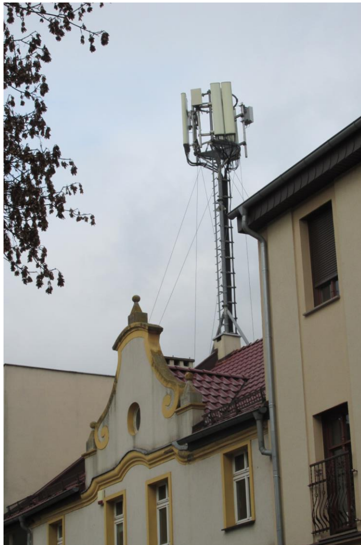
Zał. nr 1: Widok ogólny instalacji radiokomunikacyjnej.
