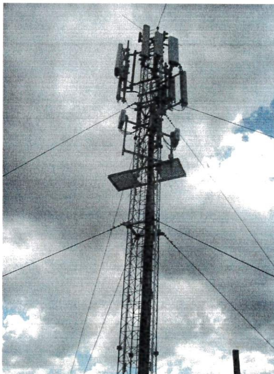
Zał. nr 1: Widok ogólny instalacji radiokomunikacyjnej.
